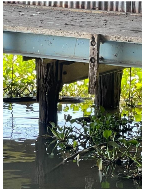
Condición actual de los pilotes
